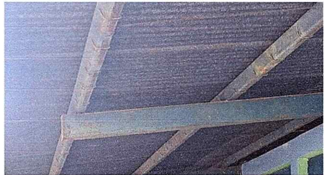
Foto 4: Se observa que la costanera esta en buen estado pero es necesario pintar y el cambio de laminas. MODULO 1
